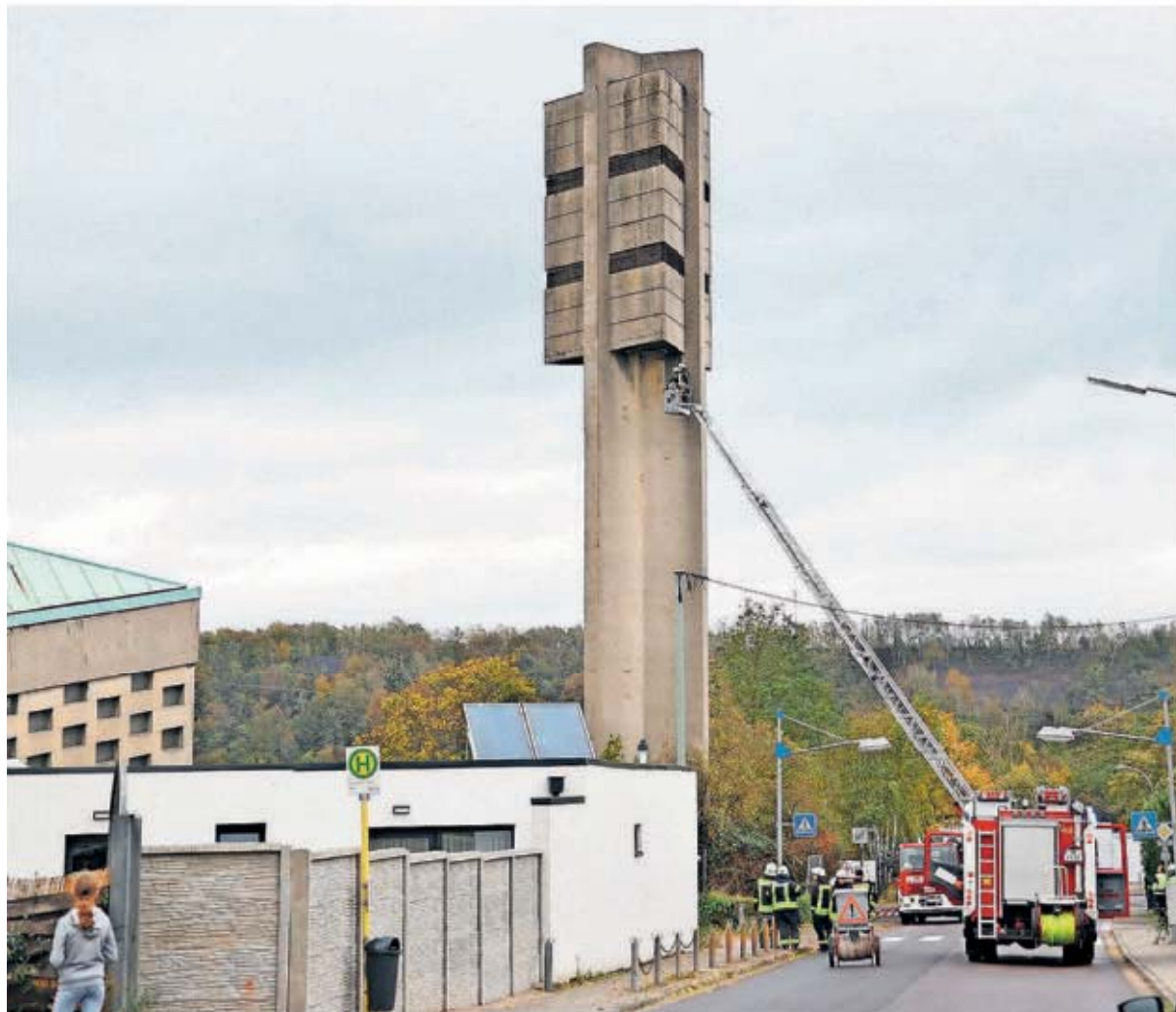
In Völklingen-Fenne drohten an der ehemaligen Kirche St. Antonius durch Sturmtief „Ignatz“ lose Teile vom meterhohen Glockenturm in die Tiefe zu stürzen. Die Feuerwehr rückte an und sicherte die Gefahrenstelle. FOTO: BECKERBREDEL
