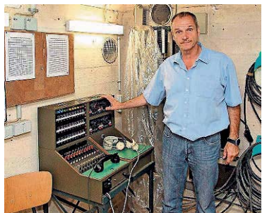
Andreas Heisel bedient die alte Telefonanlage noch immer wie im Schlaf.
